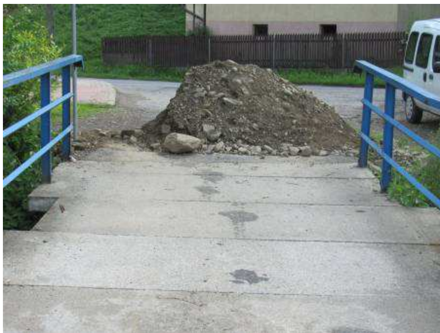
Fot. 5 Przesunięcia prefabrykowanych płyt żelbetowych oraz ubytki betonu.
