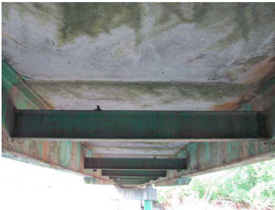
Fot. 4 Korozja dźwigarów i zacieki spowodowane przenikaniem wilgoci.
