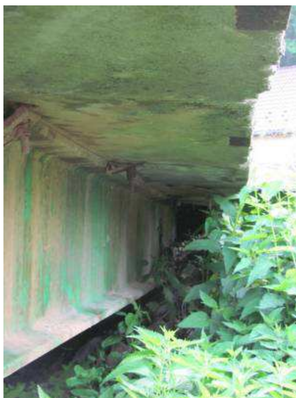
Fot. 6 Uszkodzenia oraz korozja elementów mocujących prefabrykowane płyty żelbetowe do dźwigarów.
