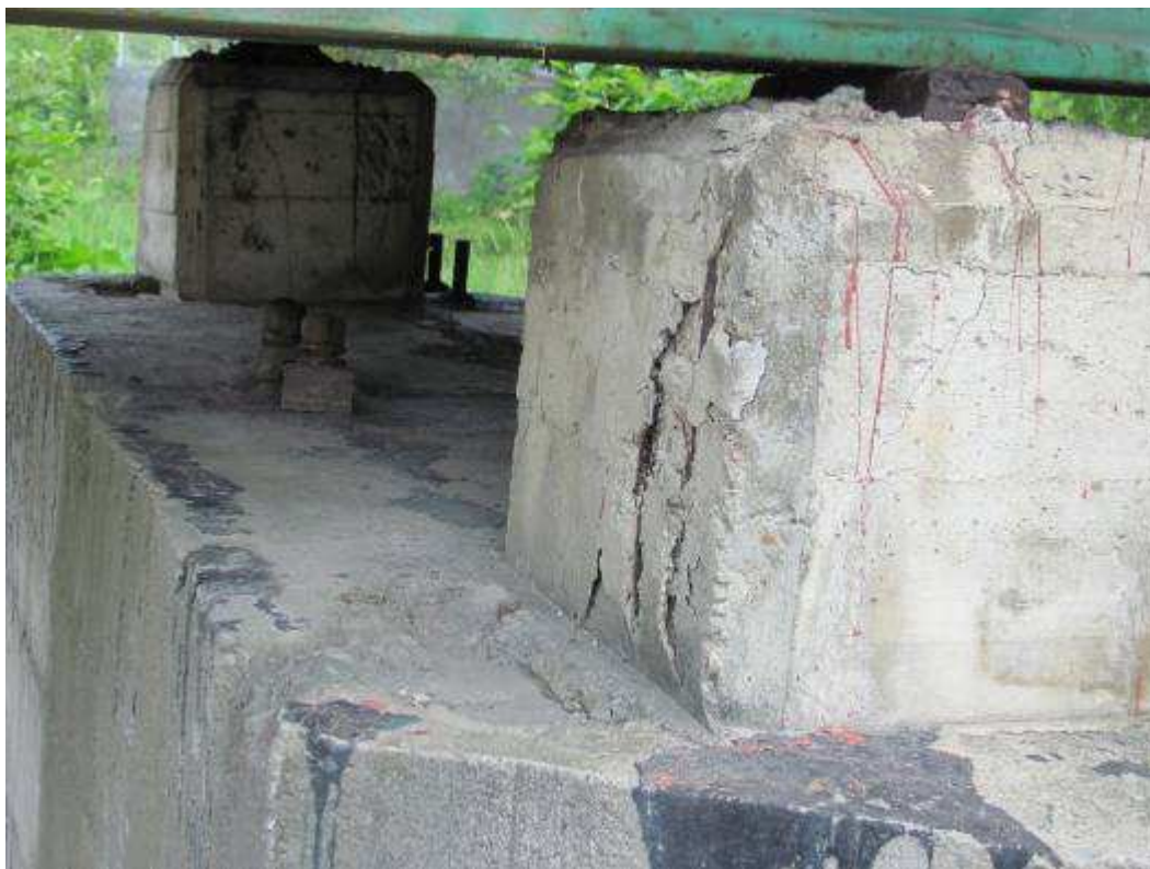
Fot. 7 Ubytki betonu odsłaniające stal zbrojeniową (druga podpora od str. prawego brzegu).
