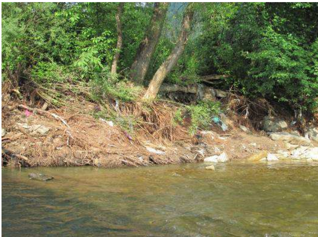
Fot. 9 Nieumocniony lewy brzeg od strony dolnej wody, widoczny podmyty system korzeniowy drzew oraz przechylenie w stronę rzeki.
