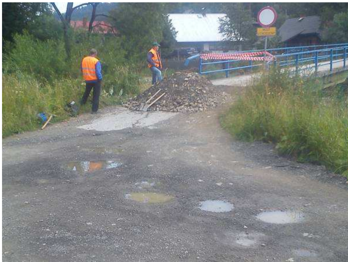
Fot. 11 Uszkodzenie nawierzchni na dojazdach do mostu.
