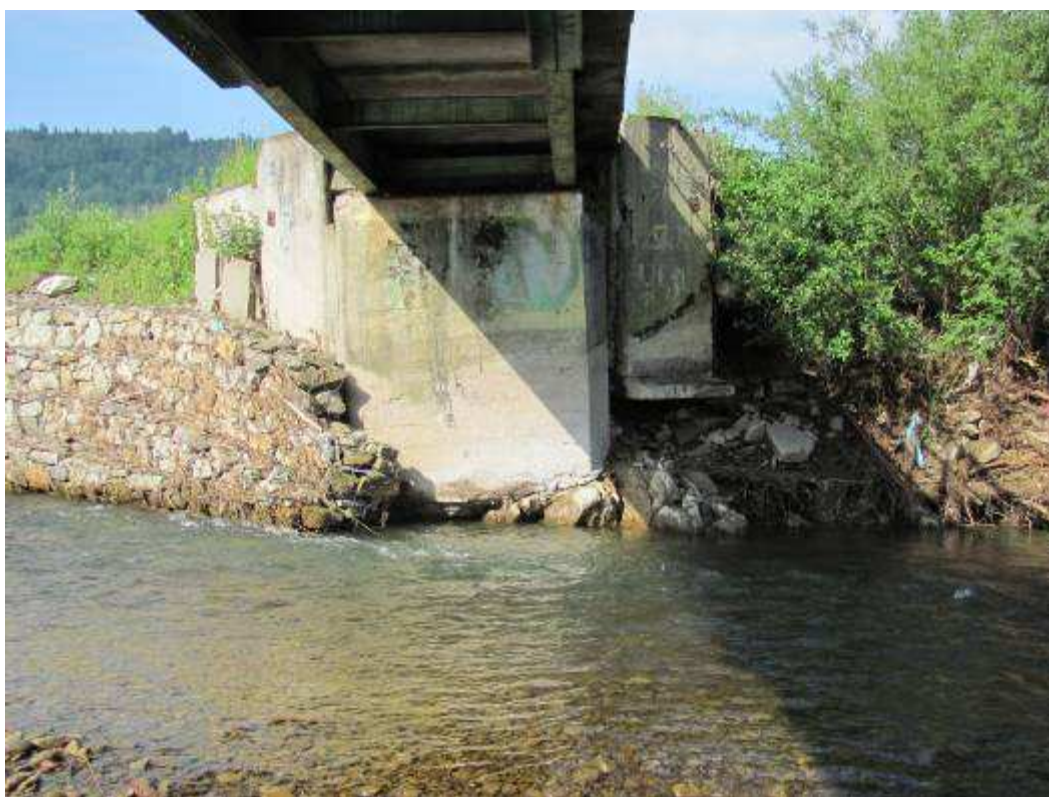
Fot. 6 Podmyty i przechylony lewy przyczółek grożący katastrofą budowlaną oraz uszkodzenia skrzydełek.
