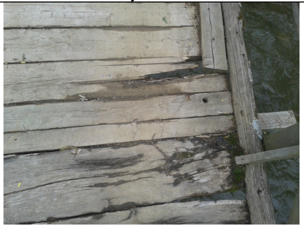
Widok przegnitych legarów mostowych
