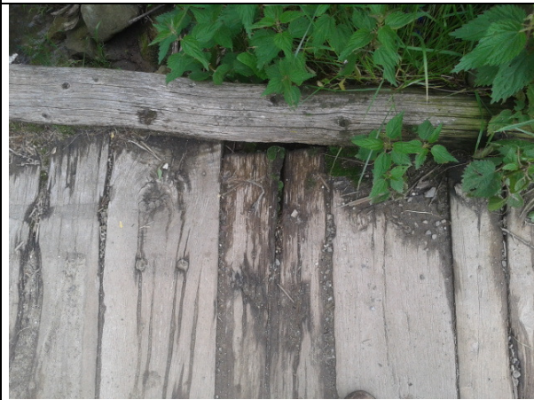
Widok uszkodzonych i przegnitych konstrukcyjnych elementów drewnianych mostku
