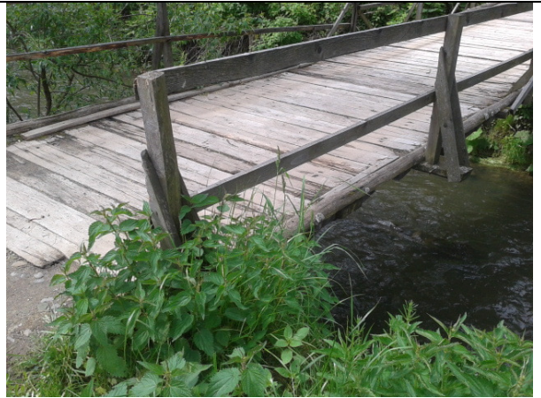
Widok uszkodzonych i przegnitych barierek drewnianych
