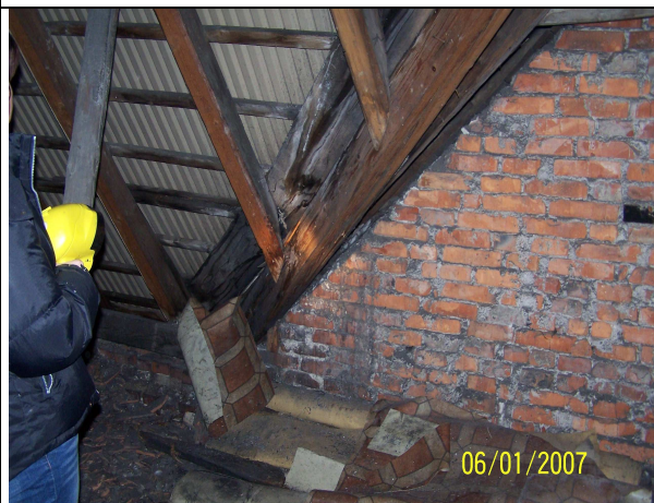
Uszkodzona krokiew koszowa
