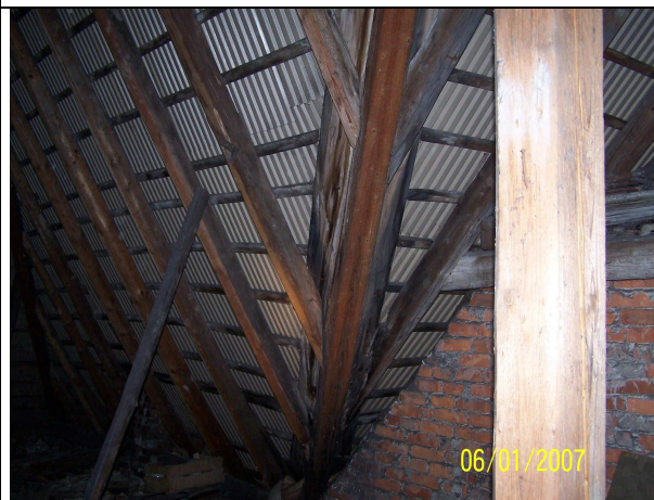
Uszkodzona krokiew koszowa
